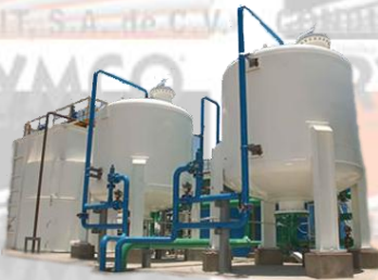
Tratamiento Agua Potable
